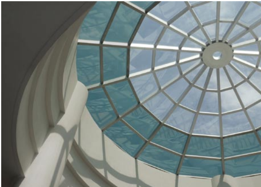
Großflächige Dachverglasungen schützen mit dem dimmbaren Sonnenschutzglas effektiv vor Überhitzung und lassen gleichzeitig viel Tageslicht herein.
