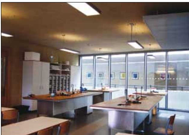
Figura 2. Eficiencia energética 1: regulación constante de la iluminación en los laboratorios con KNX. Fuente: Andromeda
